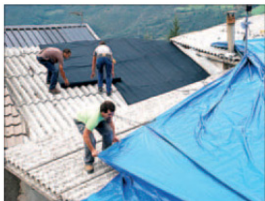
El fuerte temporal dañó los tejados de las casas
